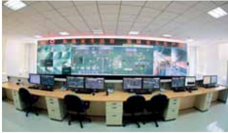
无人值守水泥生产线中控室
